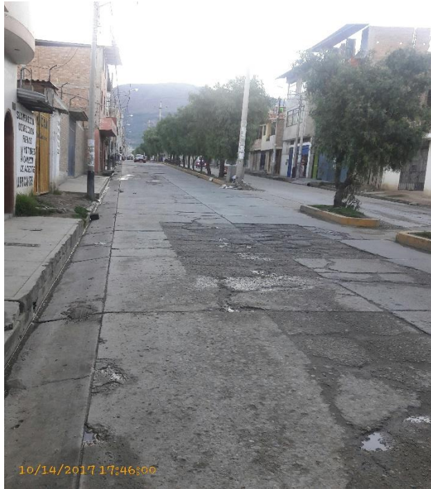
Fotografía N° 12: Mal estado del pavimento en la Av. Héroes del Cenepa
