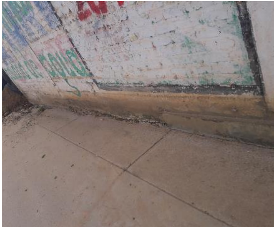
Fotografía N° 15: Falta de vereda en algunos tramos de la Av. Héroes del Cenepa
