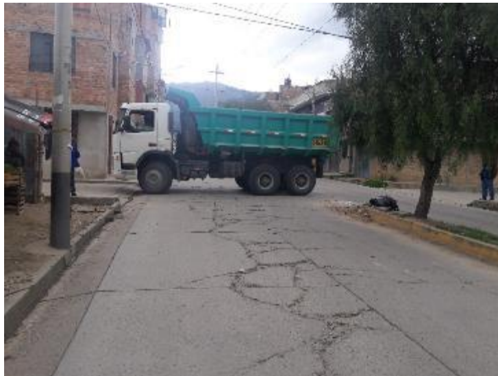
Fotografía N° 13: Deterioro en el pavimento en la Av. Héroes del Cenepa
